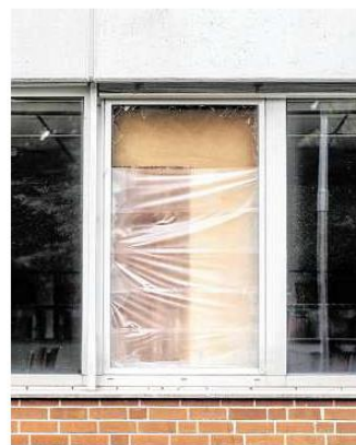
Sanierungsbedarf: Hinter diesen Mauern wird noch eine Weile unterrichtet werden.
